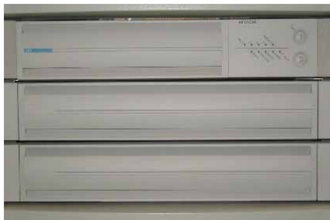
ラック搭載時(UPS とパワポックス 2 台)
